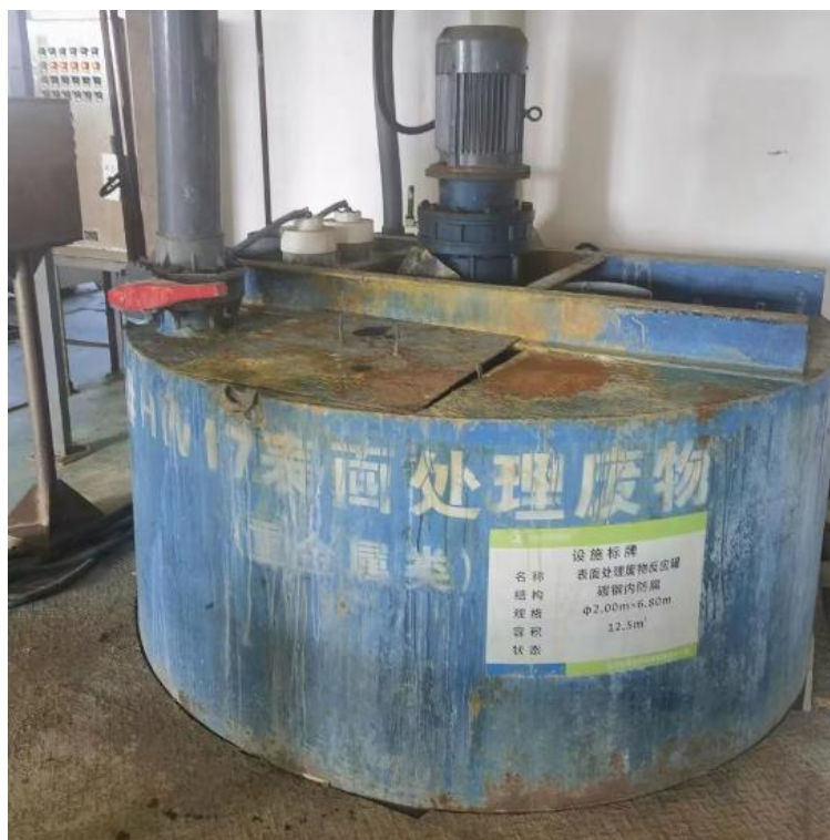
重金属废水处理系统（部分）
