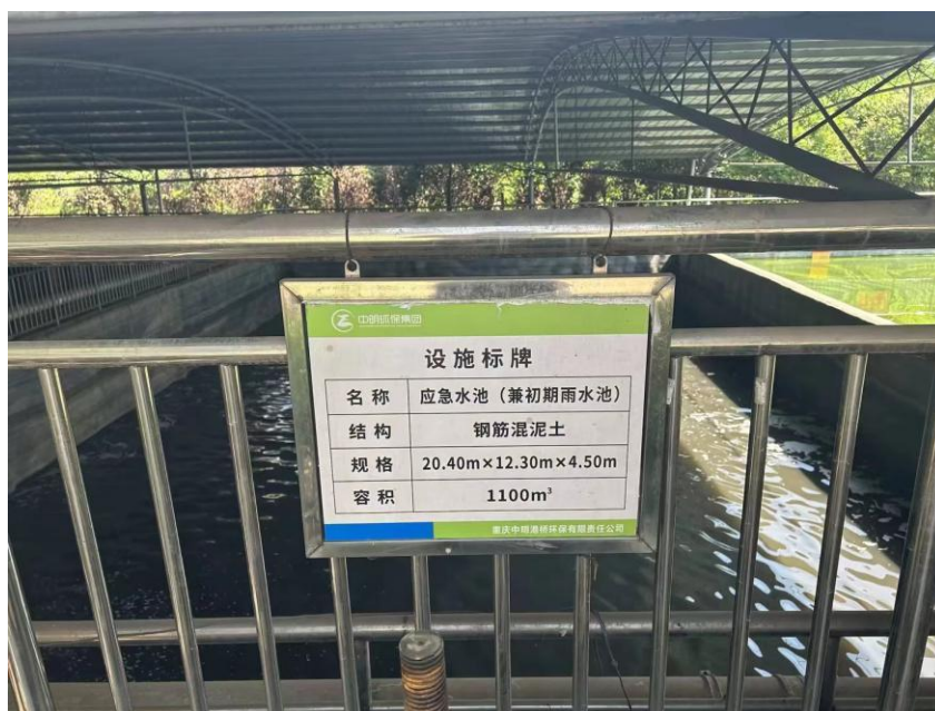
初期雨水池（兼应急事故池）（有效容积 1000m³）
