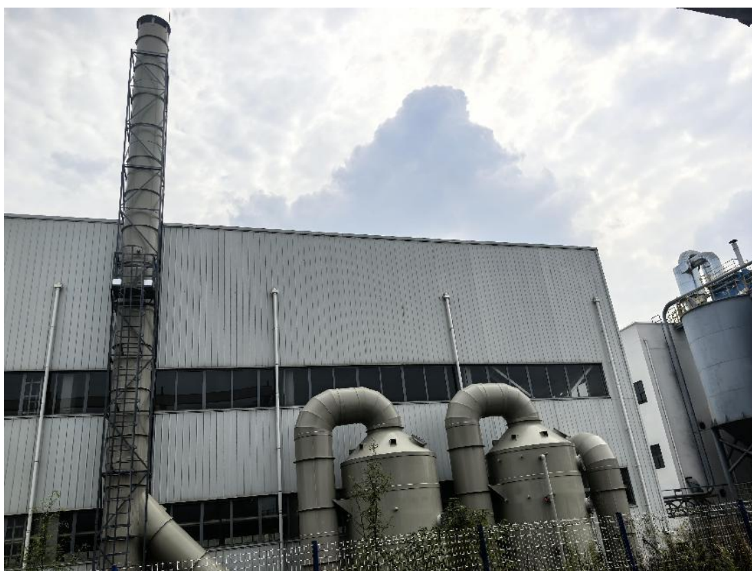
两级水喷淋塔 (DA005)
