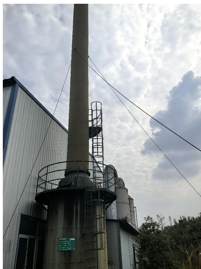
两级水喷淋塔（DA007）
