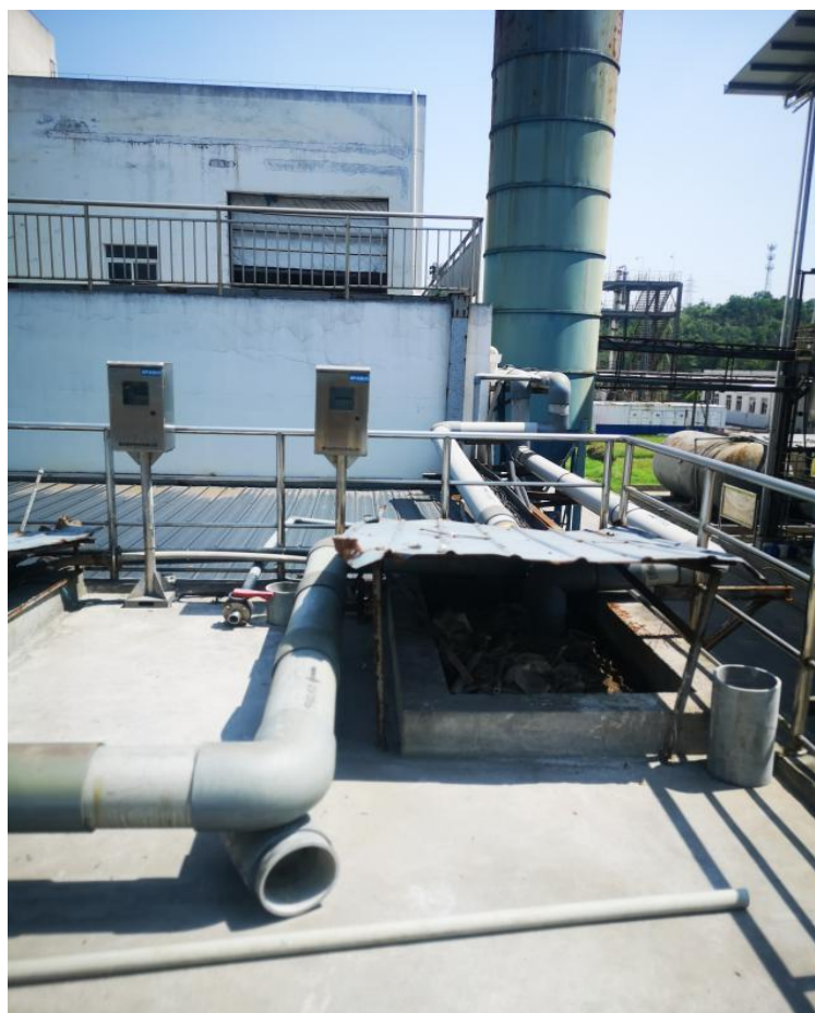
禁排类中间水池
