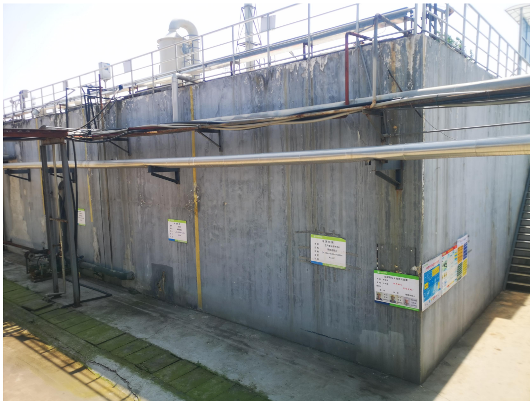
综合污水处理站（非禁排类）
