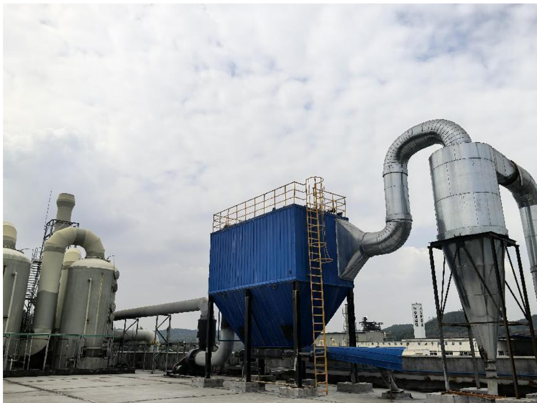
旋风除尘器+布袋除尘器+气水分离器+含氨废气吸收装置 (DA003)
