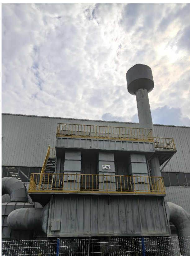
两级耐高温覆膜式 DMC 除尘器 (DA002)
