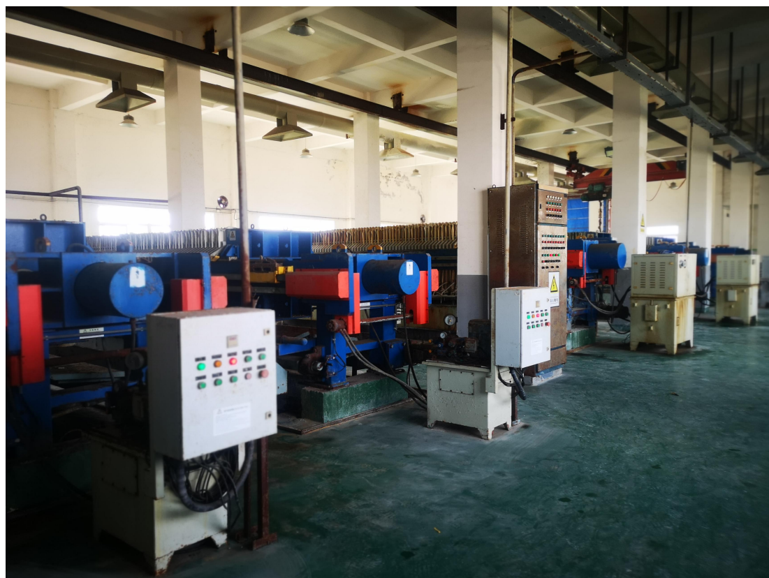
物化车间板框压滤机
