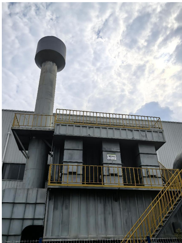
两级串联覆膜袋式除尘器 (DA001)
