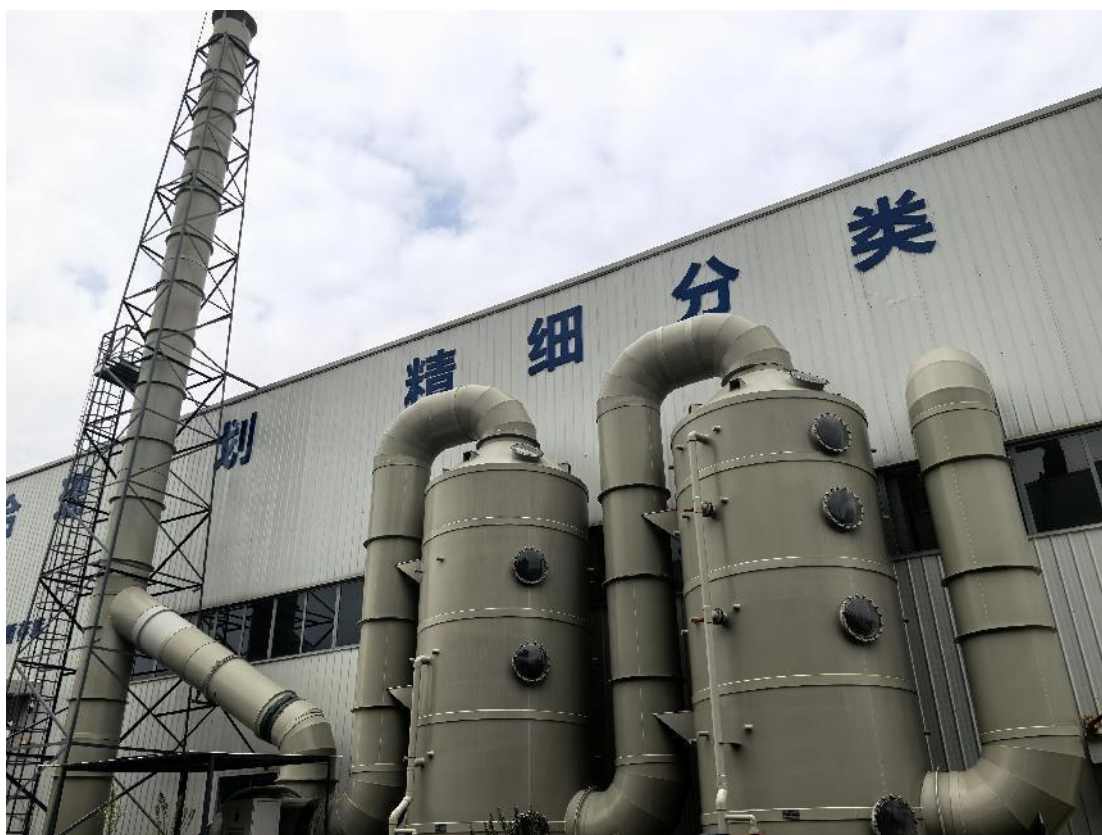
两级水喷淋塔（DA006）
